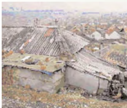
In diesem völlig verrotteten Gebäude mussten die 13 Personen der Familie Bytyqi bis vor kurzem leben. Foto: Einsatzland
